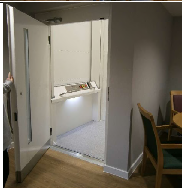
Fotografía 11. Las viviendas disponen de un ascensor completamente accesible para sillas de ruedas.
